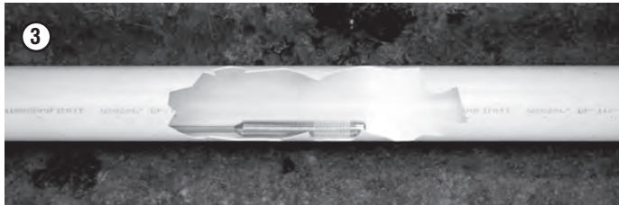
3 VUELVA A INSPECCIONAR EL TUBO PARA ASEGURAR QUE NO TENGA RESIDUOS Y PARA CONFIRMAR EL LUGAR Y EL TAMAÑO DE LA REPARACIÓN.
