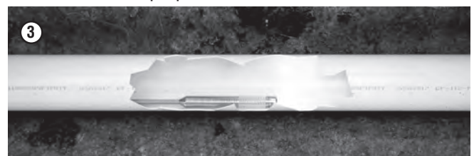
3 VUELVA A INSPECCIONAR EL TUBO PARA ASEGURAR QUE NO TENGA RESIDUOS Y PARA CONFIRMAR EL LUGAR Y EL TAMAÑO DE LA REPARACIÓN.
