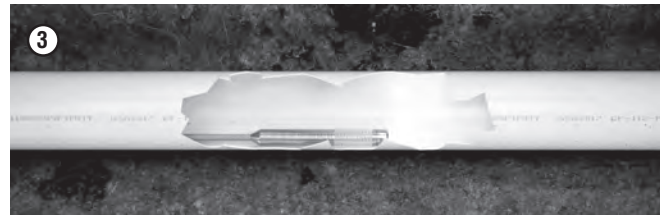
INSPECTEZ À NOUVEAU LA LIGNE POUR VOUS ASSURER QU'ELLE EST DÉBARRASSÉE DE TOUT DÉBRIS ET CONFIRMEZ L'EMPLACEMENT ET LA TAILLE DE LA RÉPARATION.
